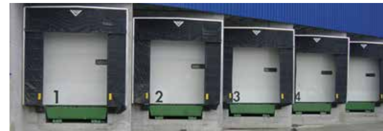
Figuur 10. Voorbeeld van docks op een distributiecentrum
